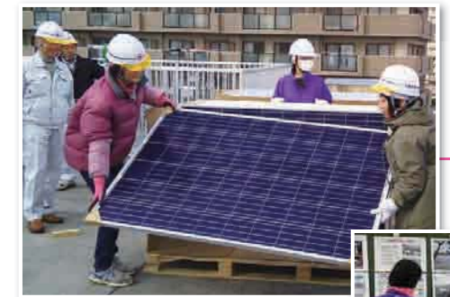
市民発電所 1～3 号機を設置（原発ゼロ市民共同かわさき発電所）
